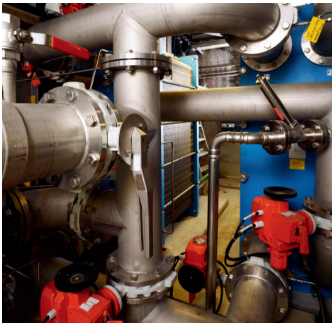
Der Brüdenampf wird über Wärmetauscher in das Nahwärmenetz eingespeist
