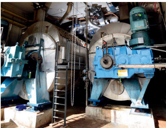
Klärschlamm wird in den Scheibentrocknern konzentriert
