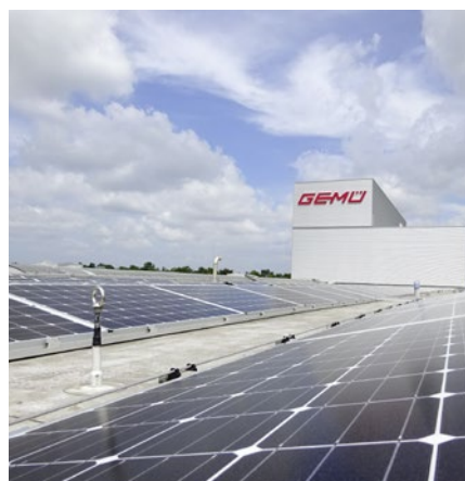
Photovoltaikanlage auf Produktions- und Logistikzentrum Europa
