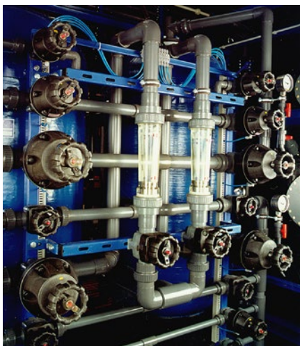
Abwasseranlage mit PVC/PE-Komponenten
