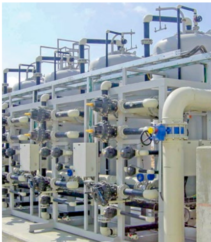
Wasseraufbereitung (Fa. Treitel Chemical Engineering Ltd)
