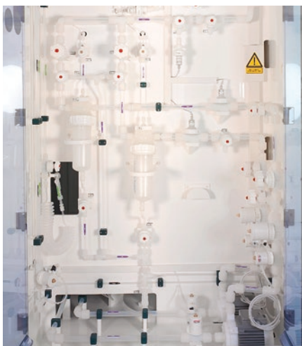
Versorgungsmodul für technische Chemie
