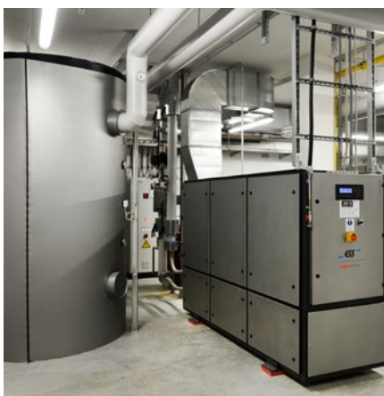
Blockheizkraftwerk im Produktions- und Logistikzentrum Europa
