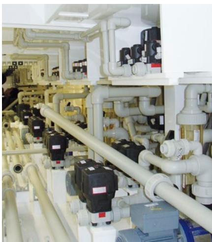
Medienbereich einer Ätz- und Reinigungsanlage
