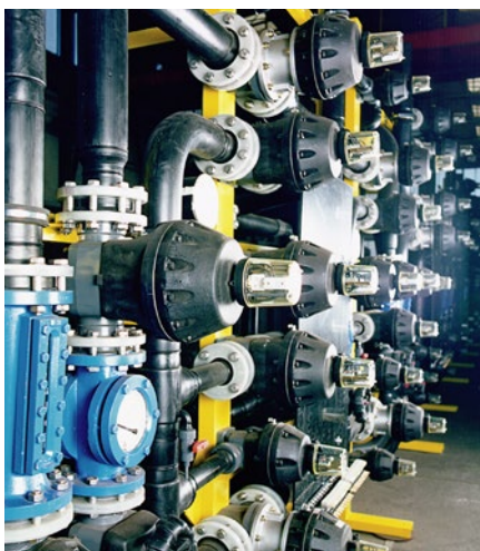
Abwasseranlage mit PVC/PE-Komponenten
